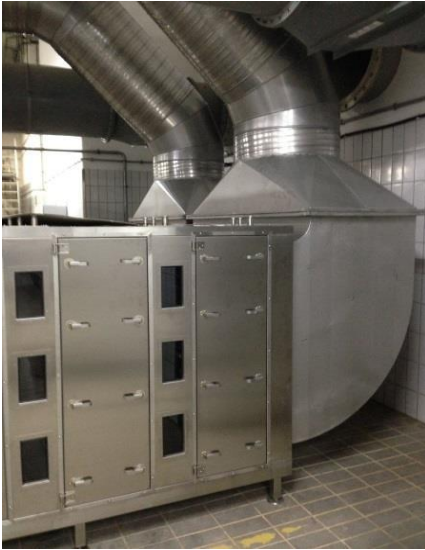
Bild 1 zeigt AerO 3 ACS-I Berliner Wasserbetriebe Abluftreinigung 2 x 15.000 m 3 /h
